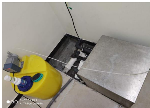
医疗废水处理设施照片
