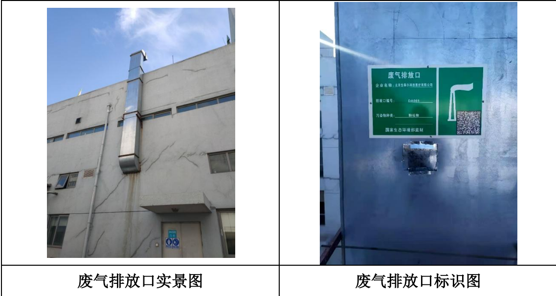
图 3-5 项目废气排放口实景图
