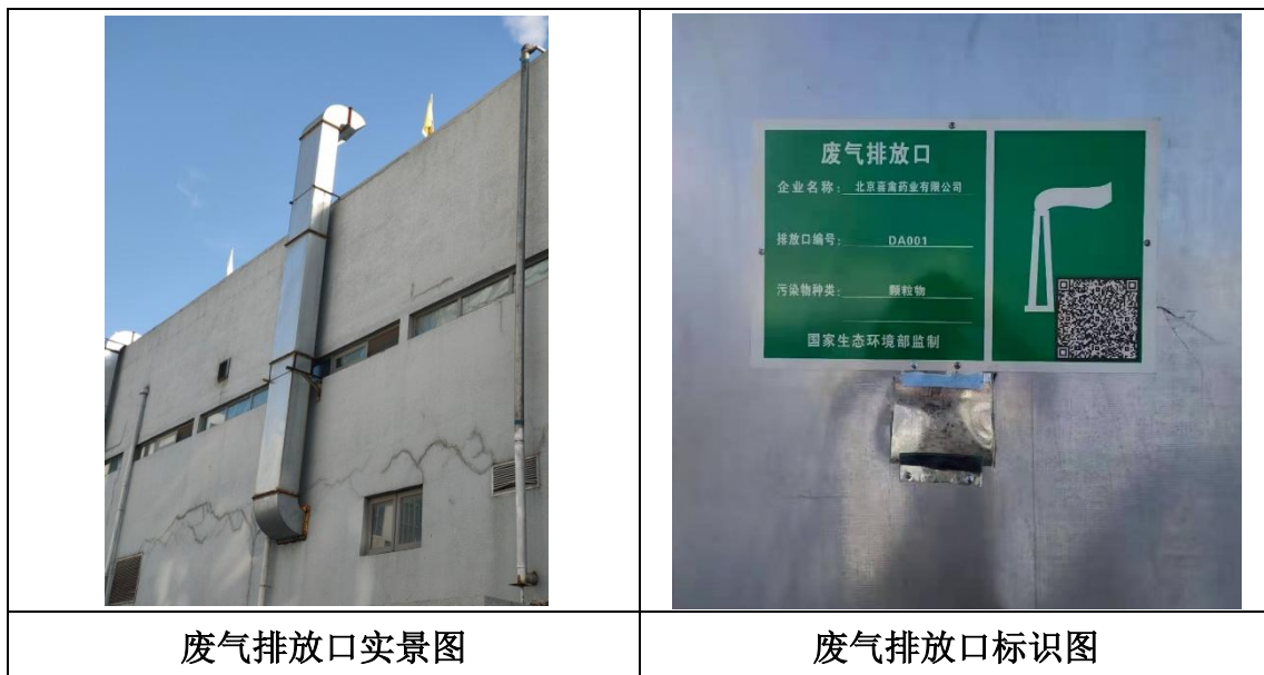
图 3-5 项目废气排放口实景图
