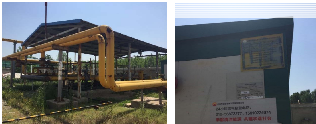
图 2.1-7 堡上产业园区现状燃气调压站
