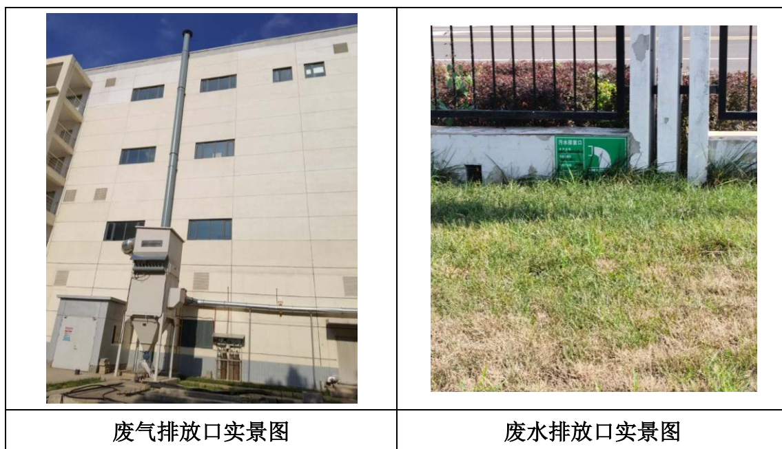
图 3-5 项目废气、废水排放口实景图
