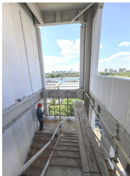
图2 楼梯拐角情况
