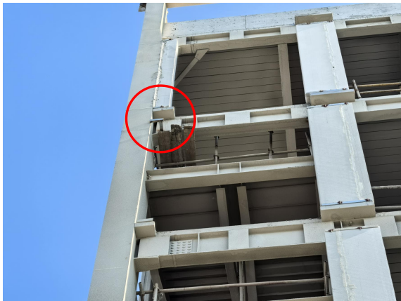
图 5 三角铁支架情况
