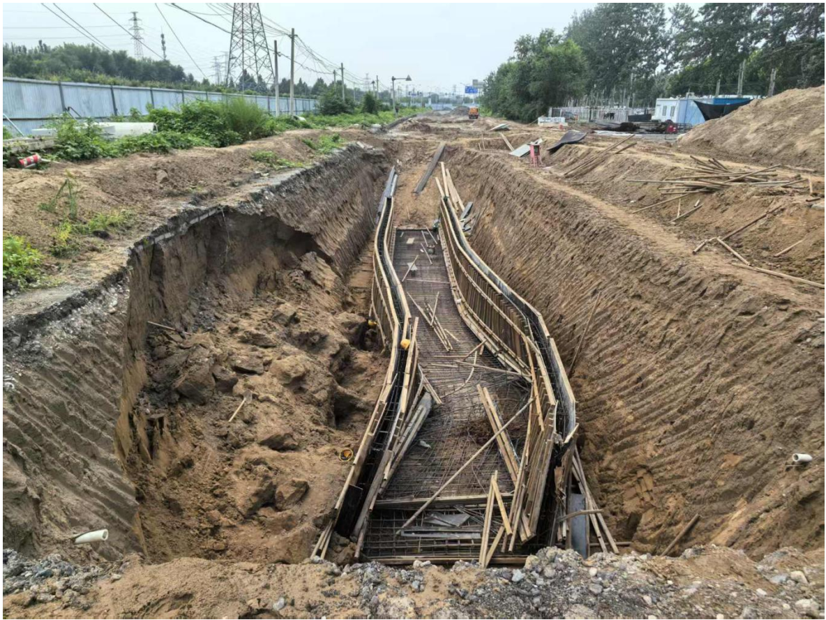
图 4 坍塌处图示（由东向西拍摄）
