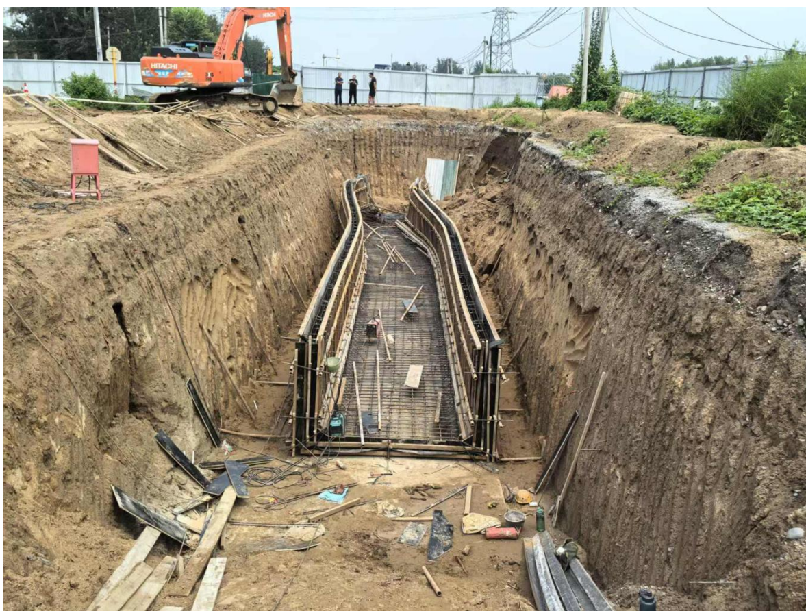
图 3 事发沟槽图示（由西向东拍摄）
