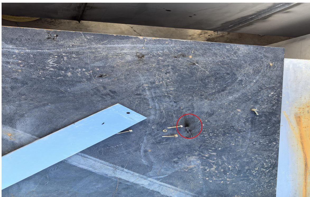
图 2 电弧灼烧痕迹图示
