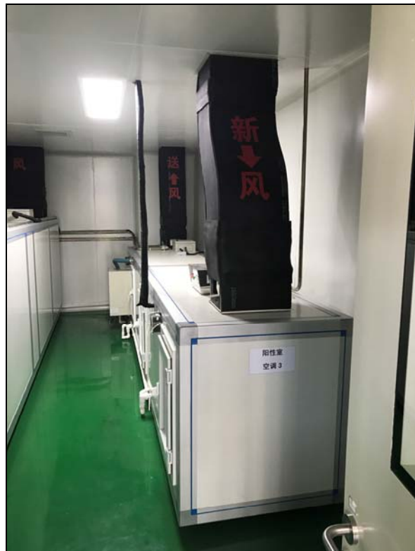
洁净间空调净化系统
