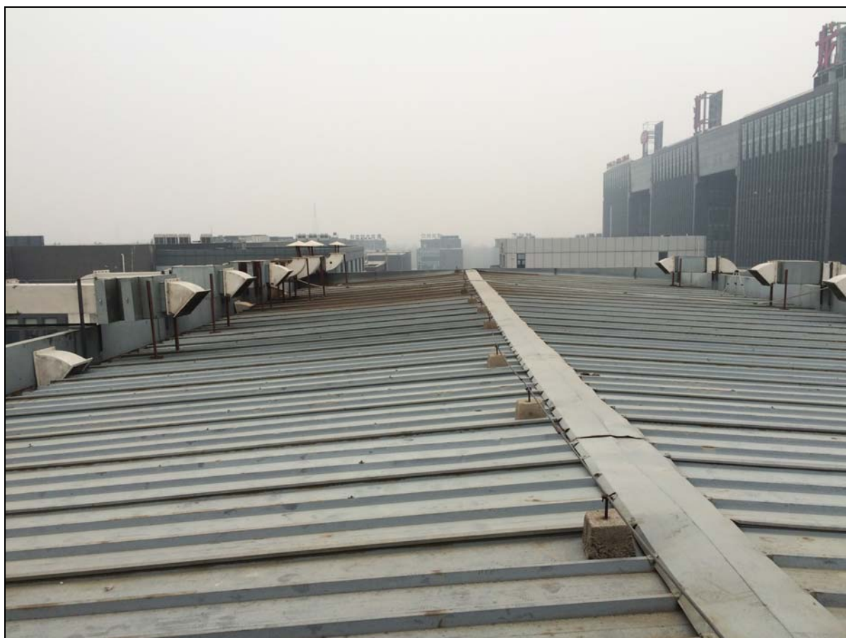
图 3-3 21 幢环境检测实验楼顶废气排放口现状照片
