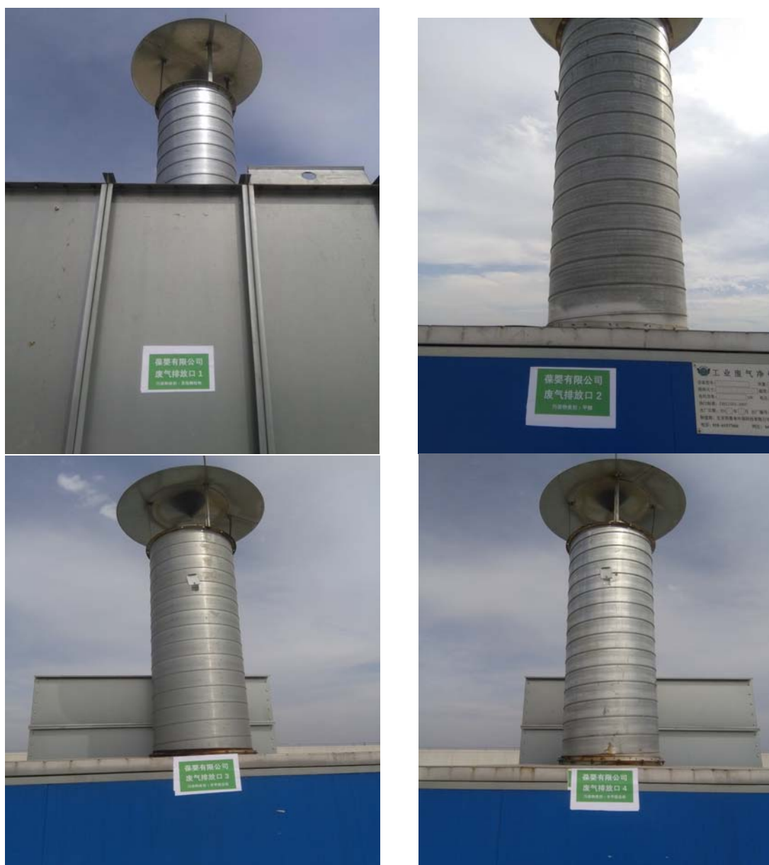
废气排放口环保标识牌
