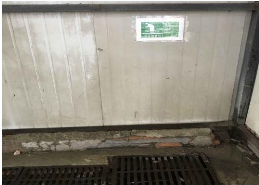
污水总排放口
