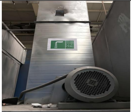
排气筒检测口及其标识
