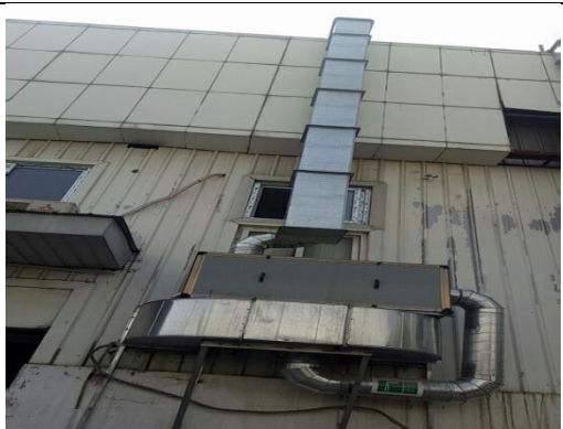
调漆房排气筒
