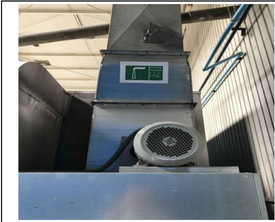
排气筒检测口及其标识
