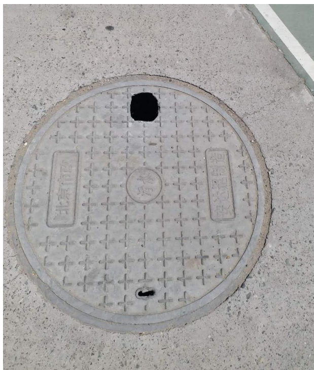
图 4.1 项目污水总排口
