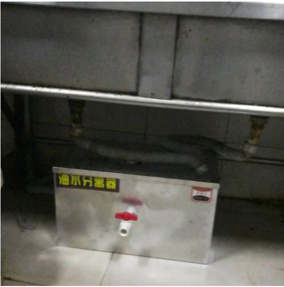
图4-2 食堂油水分离器照片
