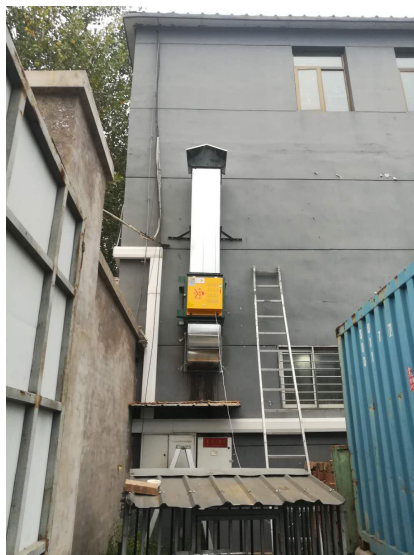
图 4-3 项目废气处理设施现场照片
