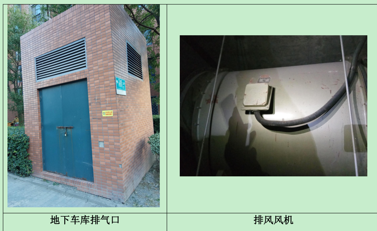
图 4-3 项目废气处理设施现场照片
