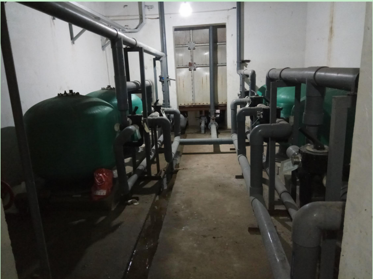
图4-1 项目自建中水处理站现场照片
