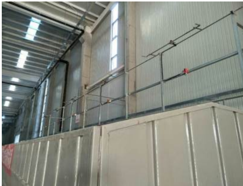
图 4.1-5 混凝土拌合站上料喷淋系统
