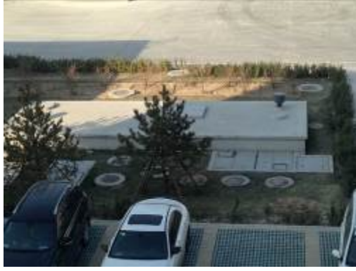
地埋式污水处理系统
