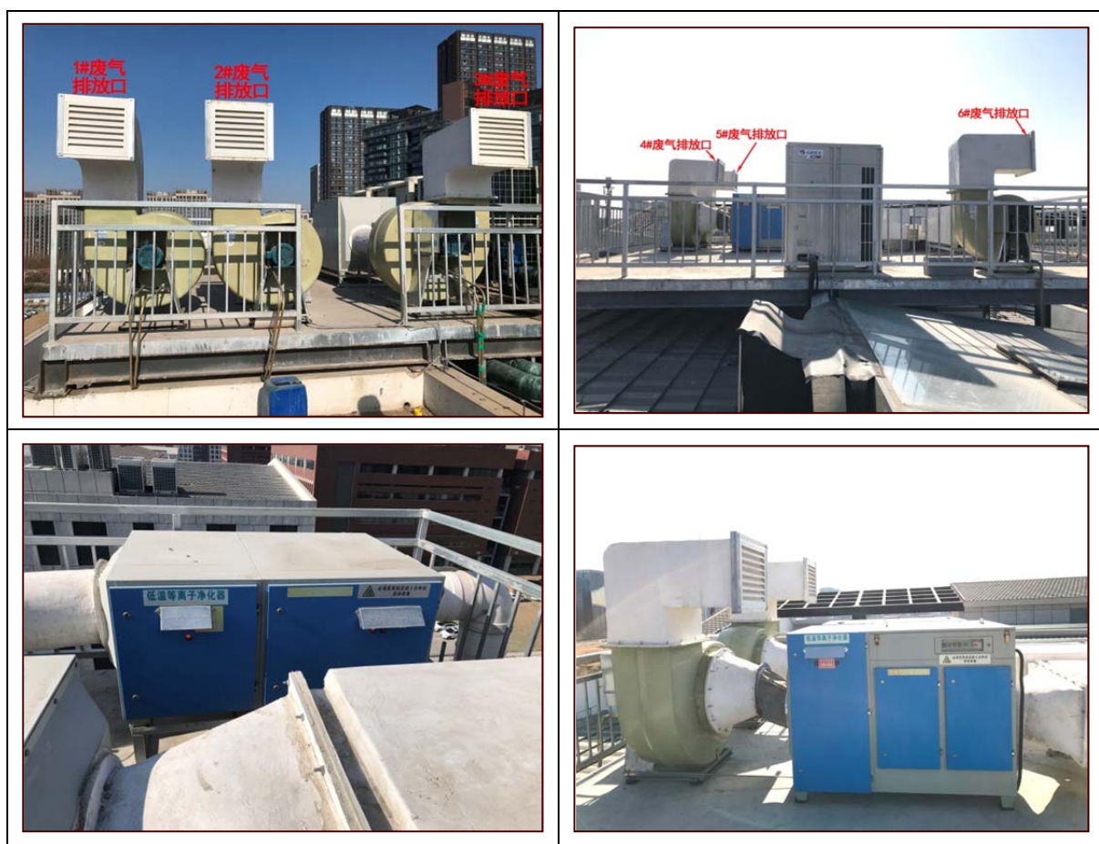
图 5-1 实验室废气净化装置现状照片
