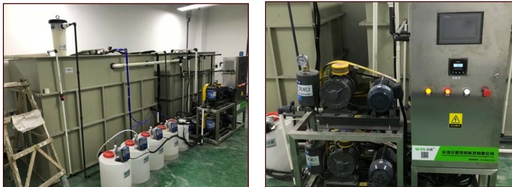
图 6-2 污水处理设备现状照片
